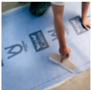
Applicera WetStop lim på golvet och runt brunns hålet. Tryck fast WetStop-mattan med Gnidde. Låt torka minst 24 timmar.
